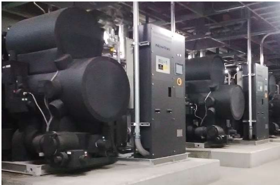
アンモニア冷凍機
