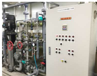
逆浸透膜(RO)ろ過装置
