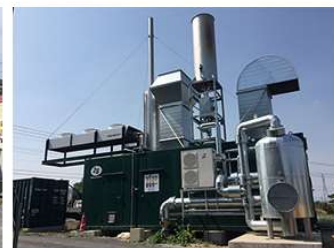
ガスの発電機
