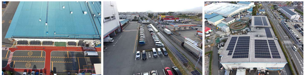
鳥栖キューピー(株)敷地内に設置した太陽光パネル 3か所
