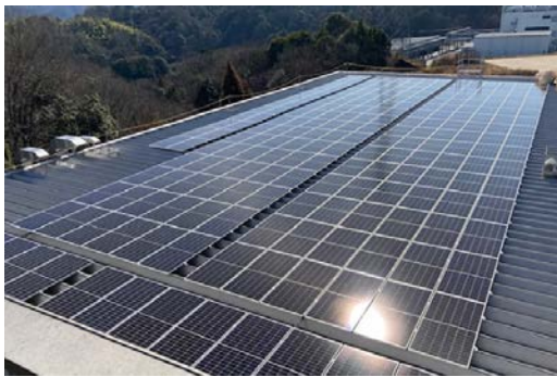
サラダクラブ 三原工場に設置した太陽光パネル
