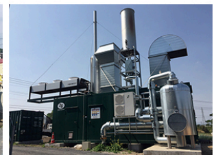
ガスの発電機
