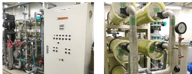
逆浸透膜（RO）ろ過装置
