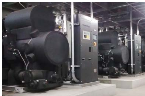
アンモニア冷凍機
