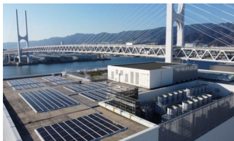
キューピー神戸工場屋上に設置した太陽光パネル
