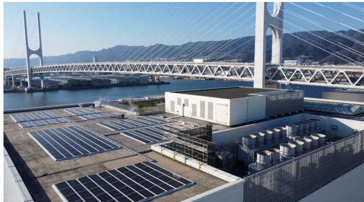
キューピー神戸工場屋上に設置した太陽光パネル
