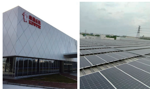
南通丘比の工場に設置された太陽光パネルの一部
