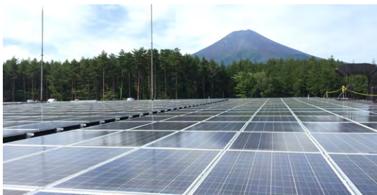
富士吉田キューピーに設置した太陽光パネル
