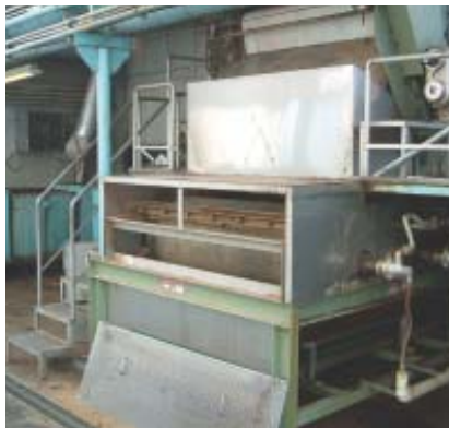
導入した汚泥乾燥機( 挙母工場 )
