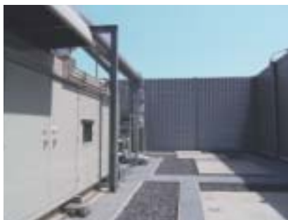
コージェネレーション設備と防音壁(中河原工場)
